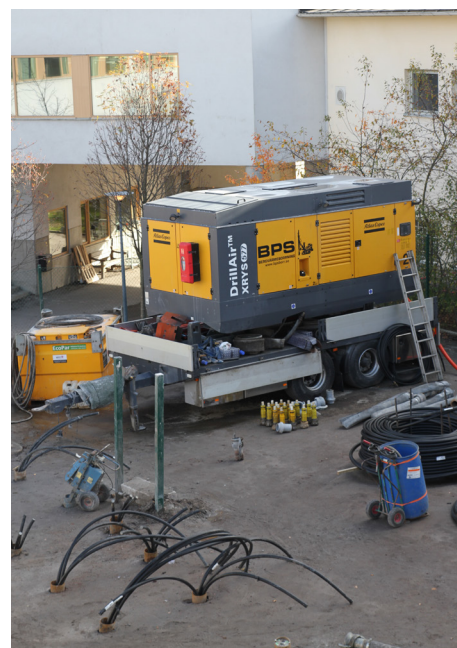
För borrhning av 80 hål på 300 meters djup med endast 1,5 meters mellanrum vid Fredhälls telestation för s k "bergkyla" för kylning av TeliaSoneras serverhallar har BPS utvecklat en metod som gör att borrhålen blir extremt raka.
