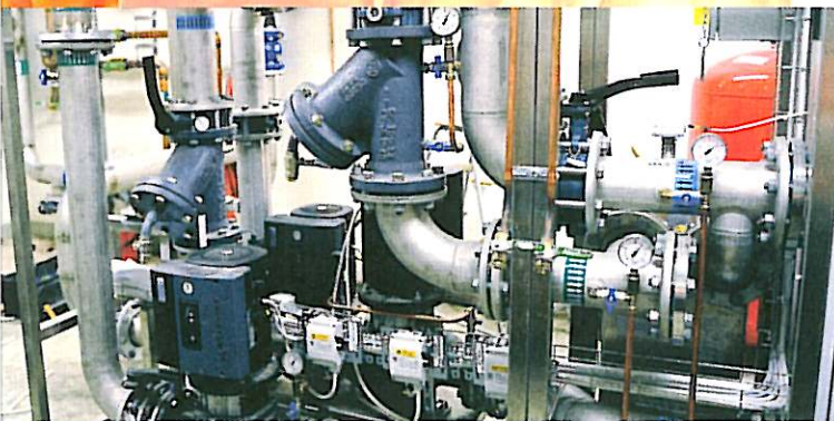
Kylsystemets hjärta. Maskinen binder samman systemets alla enheter och funktioner, och är framtagen internt av Telia.
